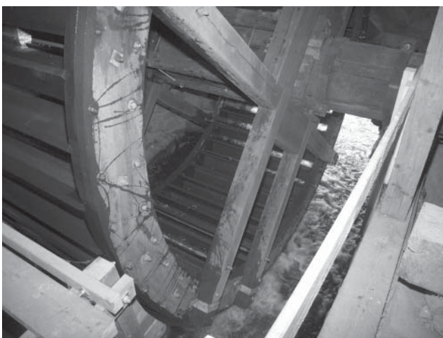
Kvarnhjulet. Ett underfallshjul som har en diameter på 4.30 meter. Ett verkligt precisionsjobb av Nossebroborna.
