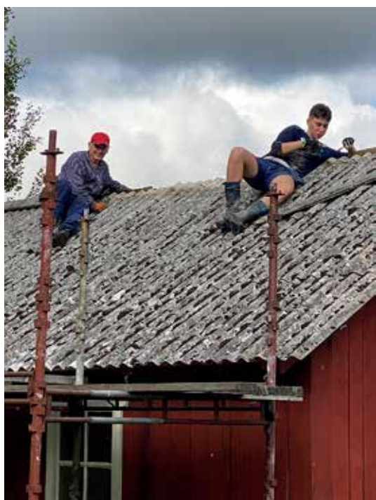
Renovering av tak på eget ägandes uthus i Herrljunga. Peter Backenfall och sonen Axel. Foto: Privat.
